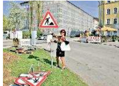
Vorsicht Baustelle! Melly Kieweg, BA 18-Vizevorsitzende und Sprecherin der Initiative »Mehr Platz zum Leben«, freut sich, dass es endlich losgeht. Foto: Hettich
